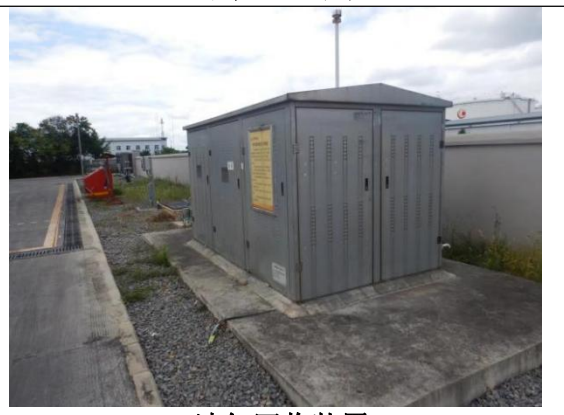
油气回收装置
