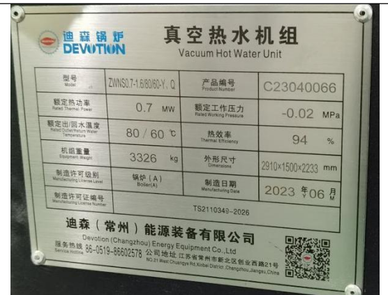
燃气锅炉（停车楼综合体内，同型号 2 台）
