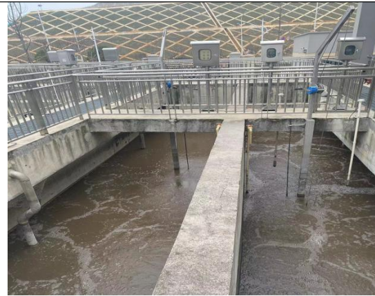
污水再生处理回用厂
