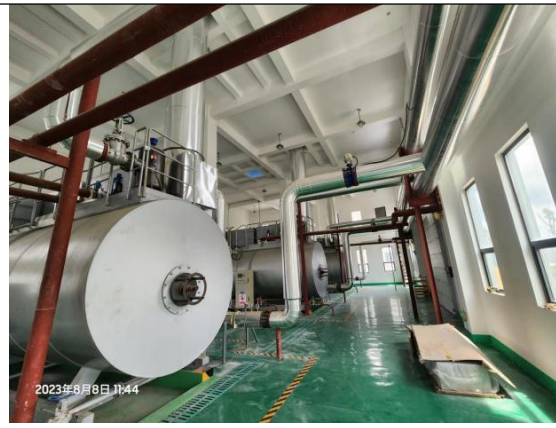
燃气锅炉（供水站内）
