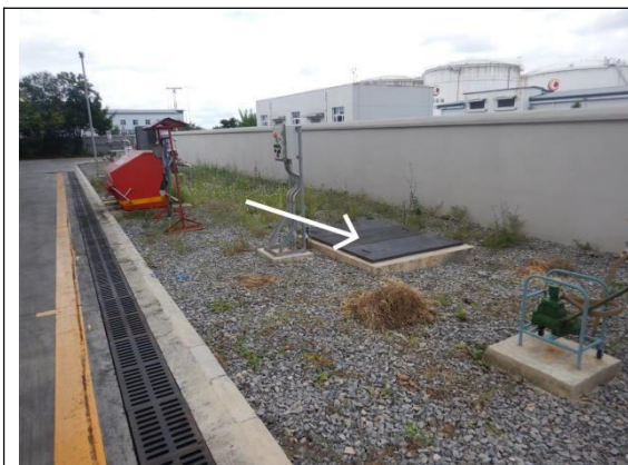
加油站应急池
