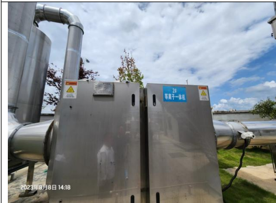
污水处理站臭气处理设施
