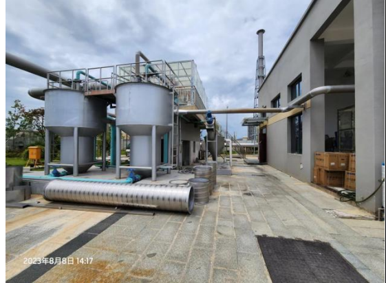
污水再生处理回用厂
