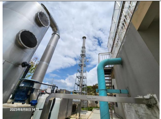
污水处理站臭气排气筒
