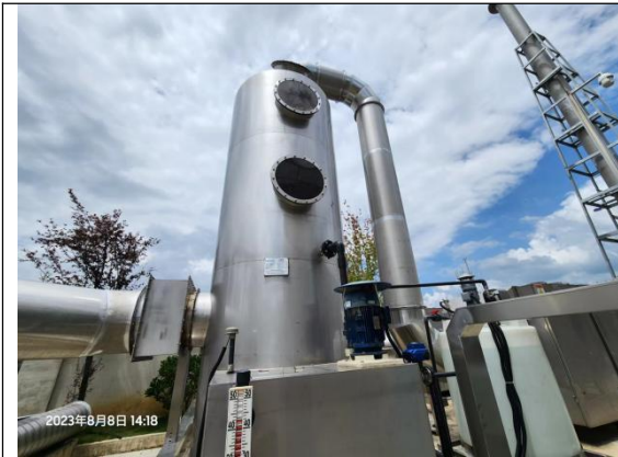
污水处理站臭气洗涤塔
